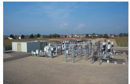
Poste de transformation 62 kV / 20 kV
