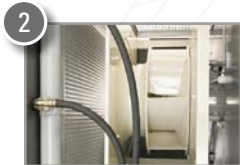
Turbine de ventilation
