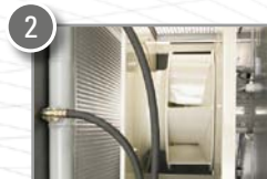
Turbine de ventilation
