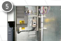
Armoire électrique VSD
